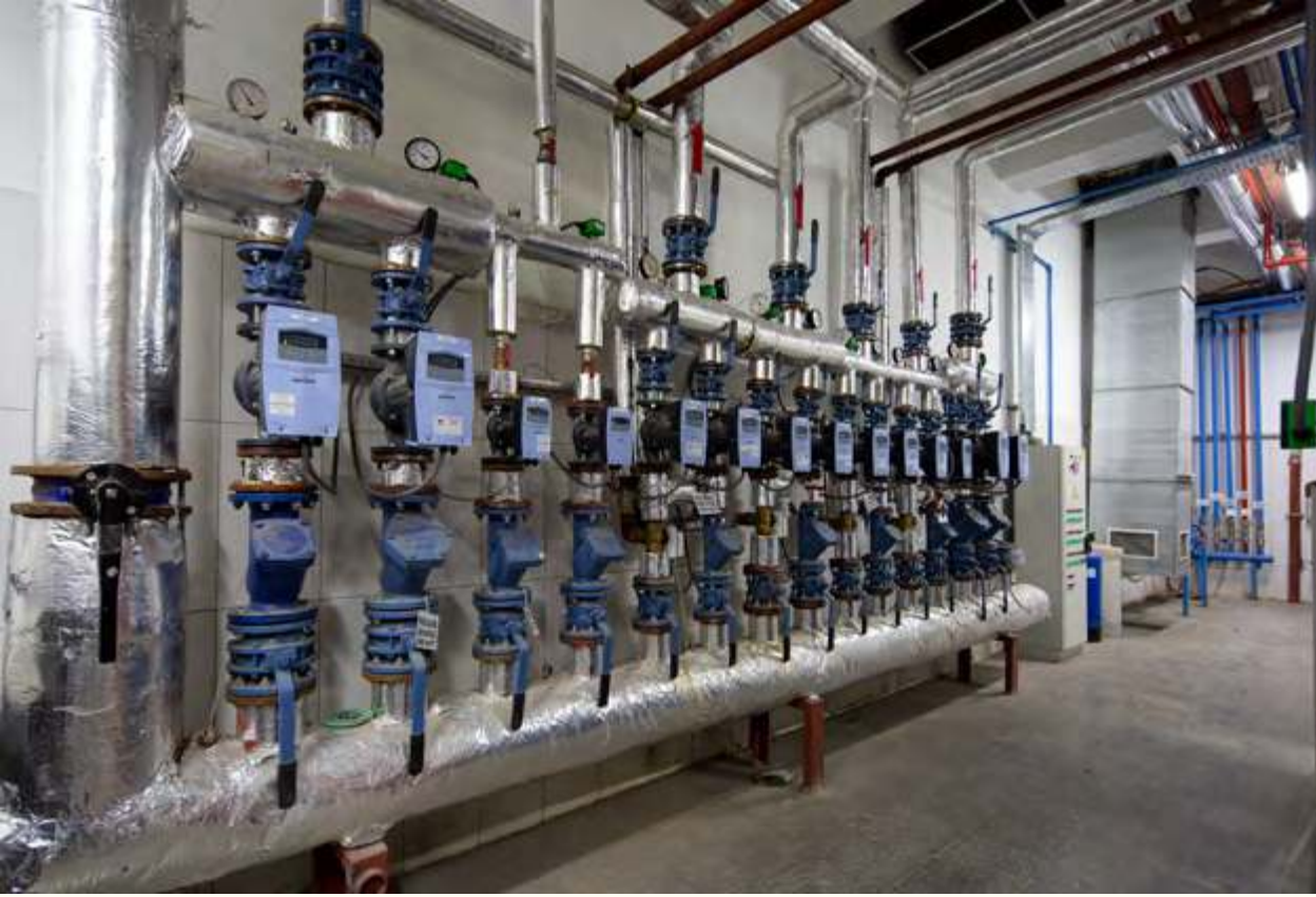
Otomasyon sistemine uyarlanmış yeni kolektör ve motor grupları.
