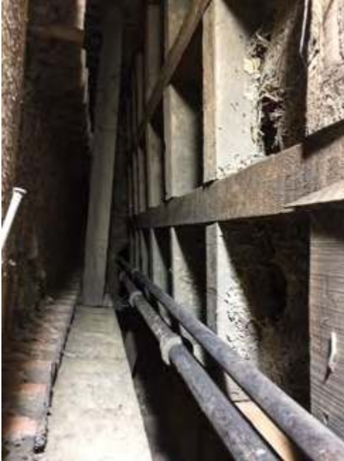
Seyirci salonu tuğla duvarı ile ahşap duvarı arasındaki boşluk ve içindeki mekanik donanım.
